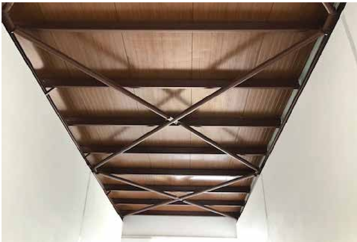
↑ Obra: Cobertura para Picadeiro // Localidade: Braga // Produtos: Estrutra: Primário Zinco EP15-410, Esmalte M-PUR // Cliente: Bemetal // Comercial: Tiago Fernandes
