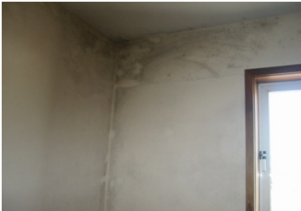
Figura I.6 - Contaminação por fungos, com incidência nas zonas de pontes térmicas
