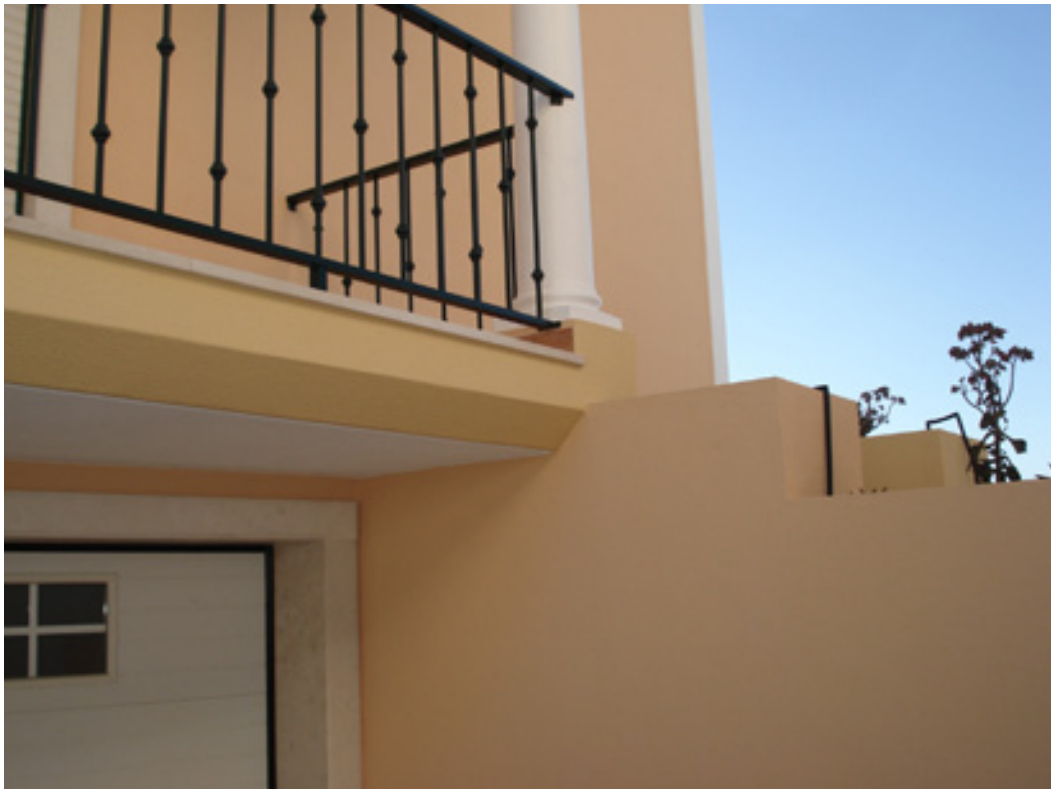
Figura I.12 - Degradação de cor da tinta de uma fachada
