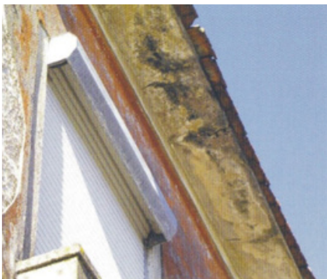
Figura III.12 - Beirado de telhado com bolores
