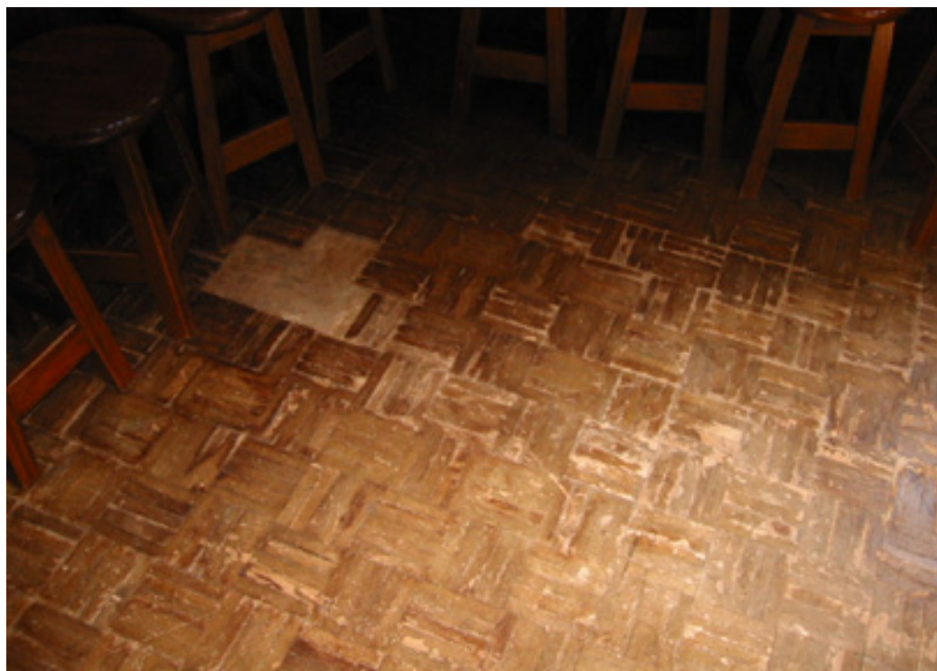
Figura X.1 - Pavimento degradado em parquet
