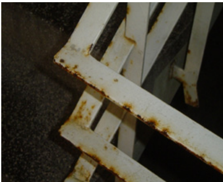
Figura V.1 - Gradeamento com ferrugem
