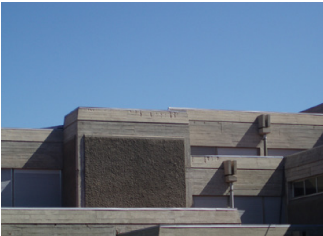
Figura II.11 - Estrutura em betão com ligeiro grau de degradação
