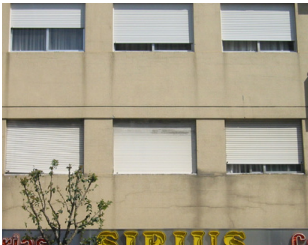
Figura II.3 - Fachada degradada em pastilha
