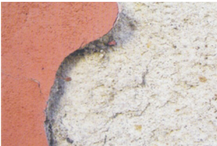
Figura I.16 - Efeito da degradação dos materiais
