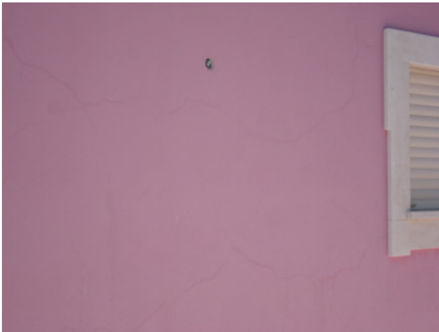
Figura XI.3 - Degradação por efeito da alcalinidade
