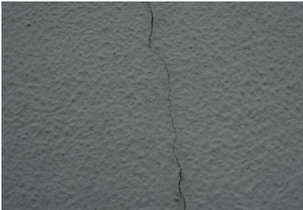
Figura II.8 - Parede com microfissuras
