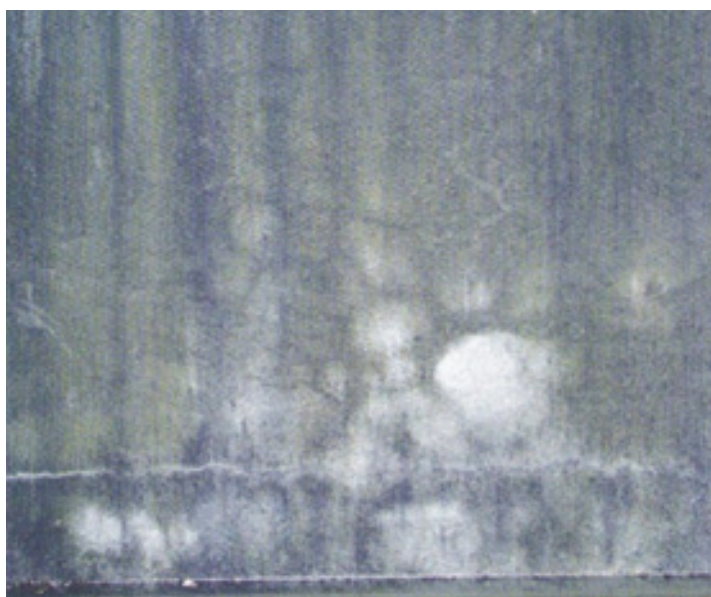
Figura II.12 - Eflorescências à superfície
