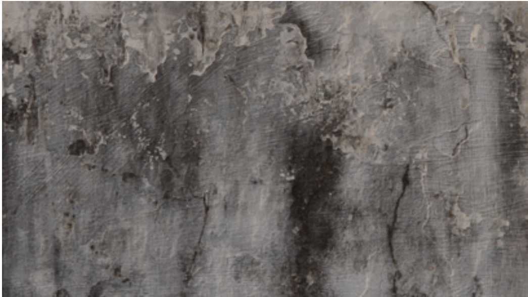
Figura I.2- Fissuras com fungos
