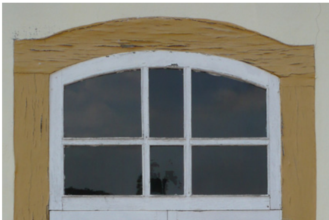
Figura VI.1 - Despelamento do revestimento por pintura
