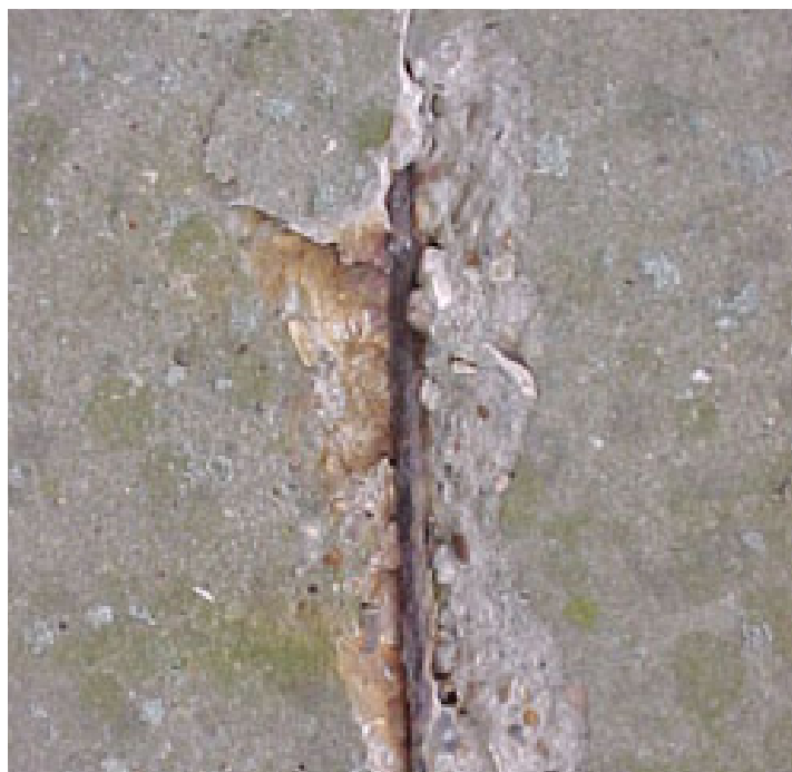
Figura II.13 - Fissuração do betão armado
