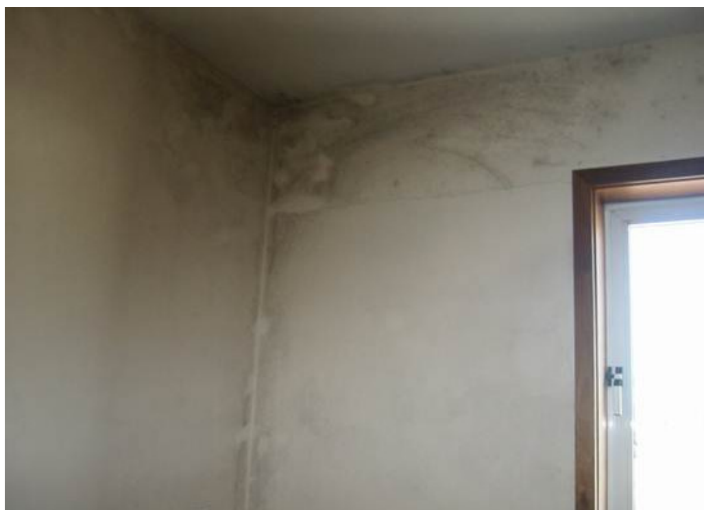
Figura VII.1 - Paredes e teto com fungos
