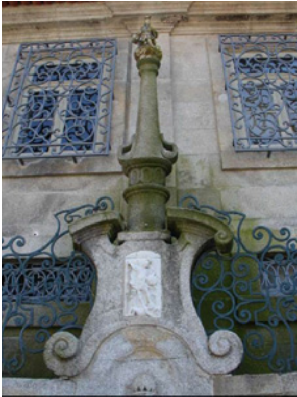
Figura VII.2 - Pedra com crescimento de fungos
