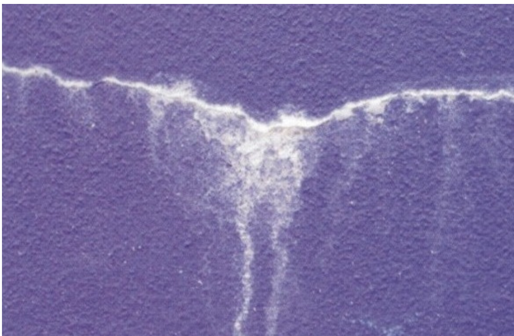
Figura I.3- Fissura com cristalização de sais
