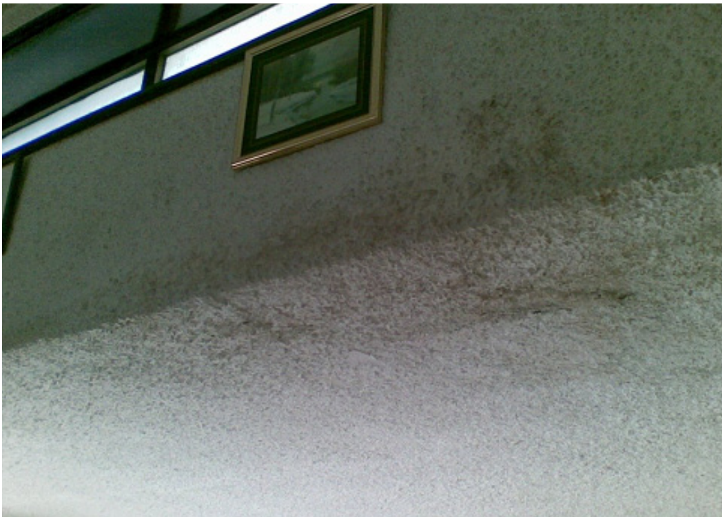
Figura IV.4 - Manifestação de infiltração no interior da habitação
