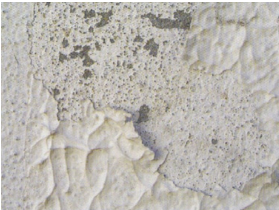
Figura II.10 - Membrana elástica danificada
