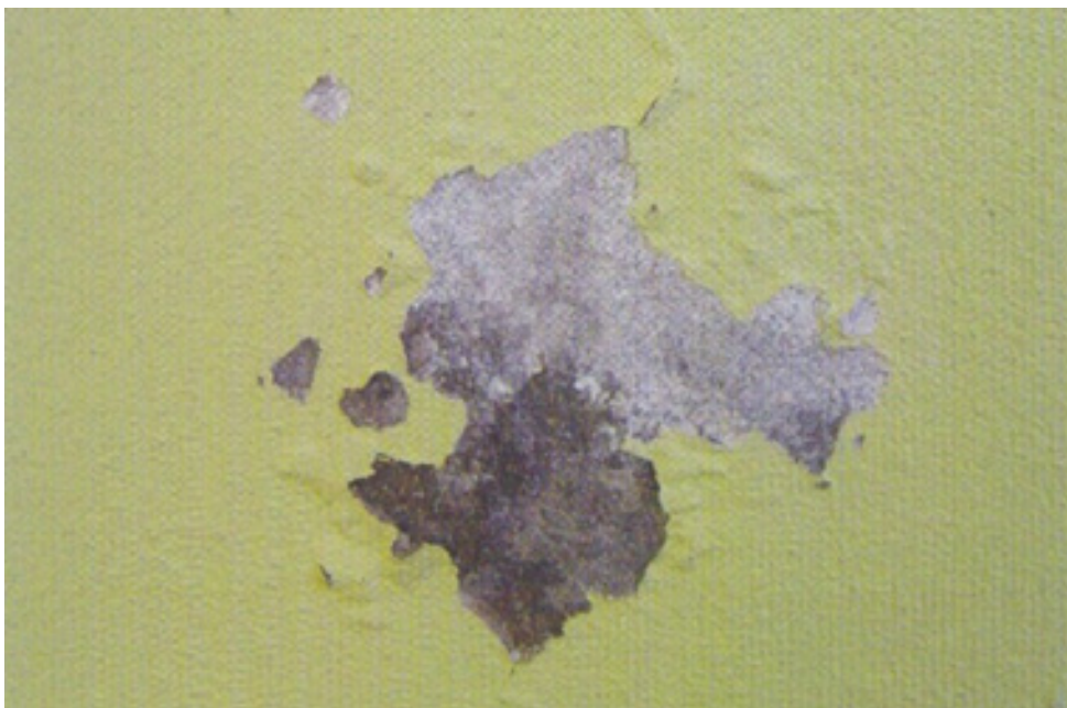
Figura I.8 - Efeito da infiltração de água numa fachada que provocou eflorescências com descasque
