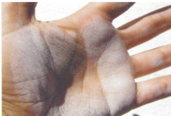
Figura I.14 - Resíduos de tinta pulverulenta retirada de uma fachada
