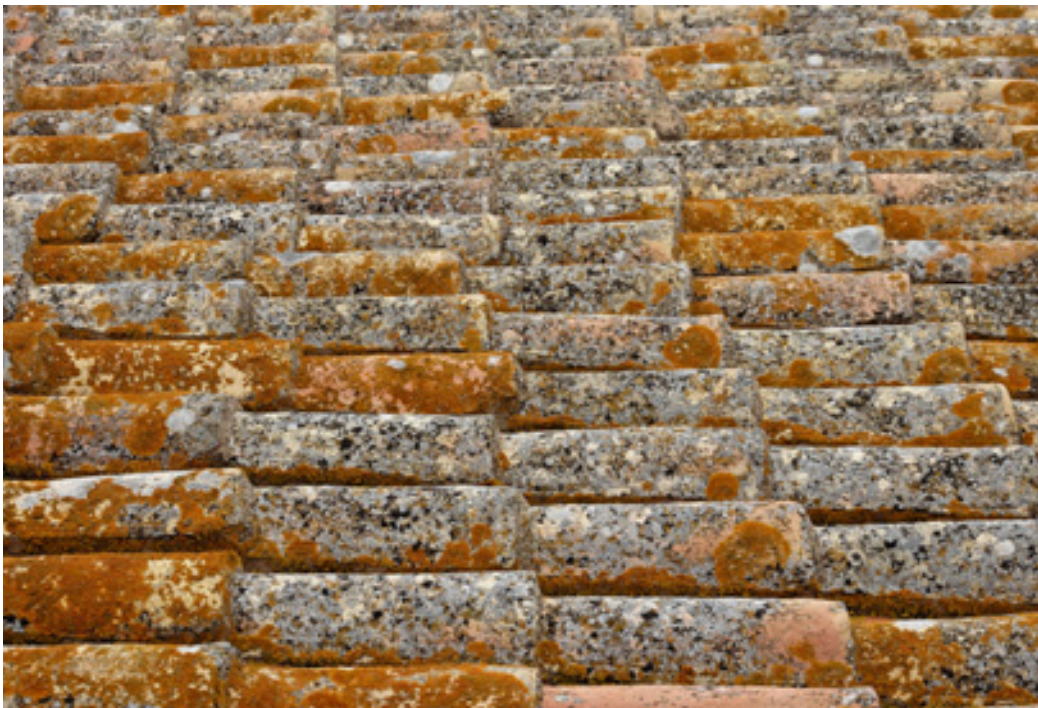
Figura III.1 - Telhado, em telha de barro, com fungos e musgos
