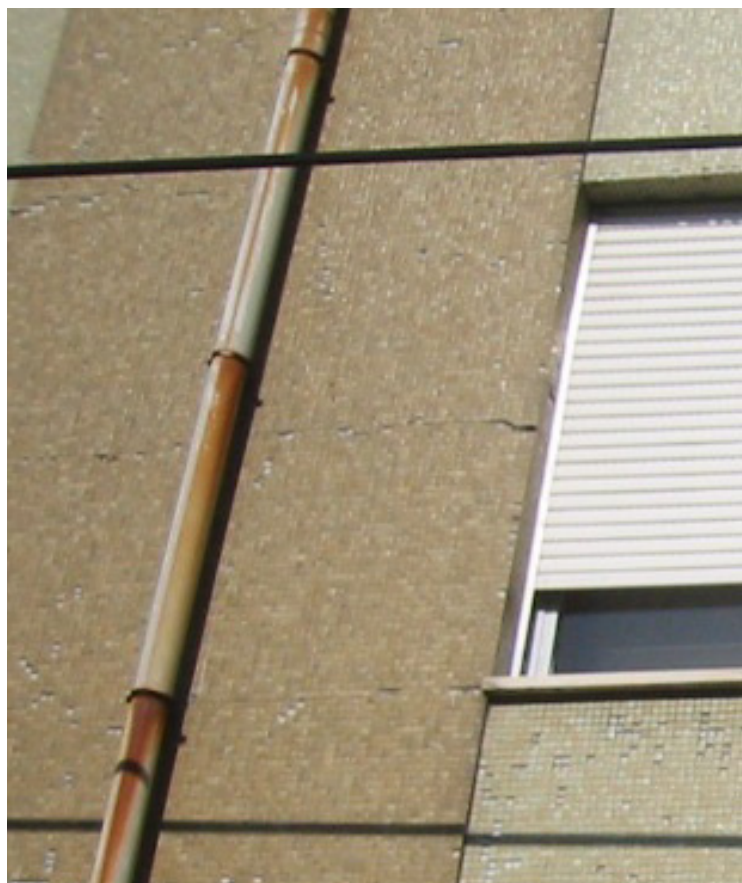
Figura III.9 - Tubo de queda com suportes enferrujados
