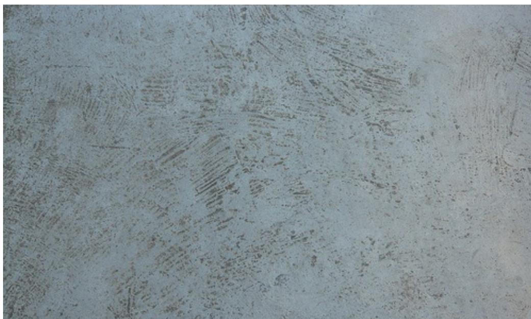
Figura X.5 - Pavimento de betão com sujidade acumulada nos poros
